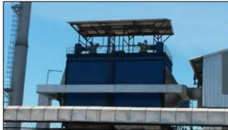
By-pass ducto gases
