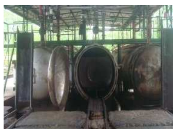
Figura 55. Mantenimiento general de los esterilizadores.
