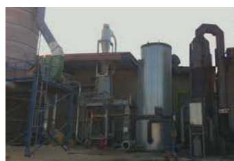
Figura 60. Mantenimiento general del área de calderos.
